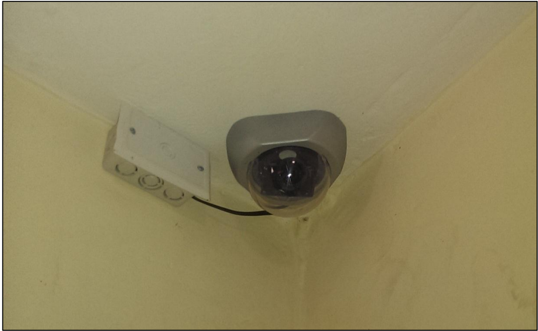
Figura 32: Cámaras Domo - Implementación de sistema de video vigilancia Fuente: Elaboración propia
