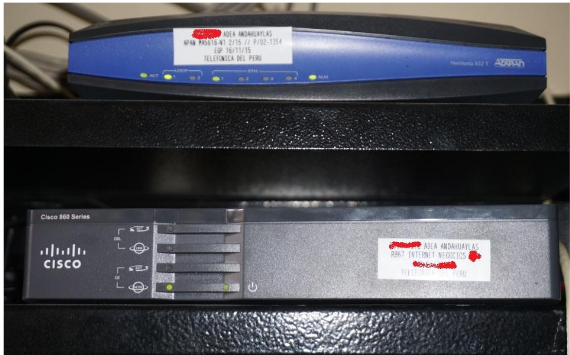
Figura 38: Equipos de comunicación en la sede central Fuente: Elaboración propia
