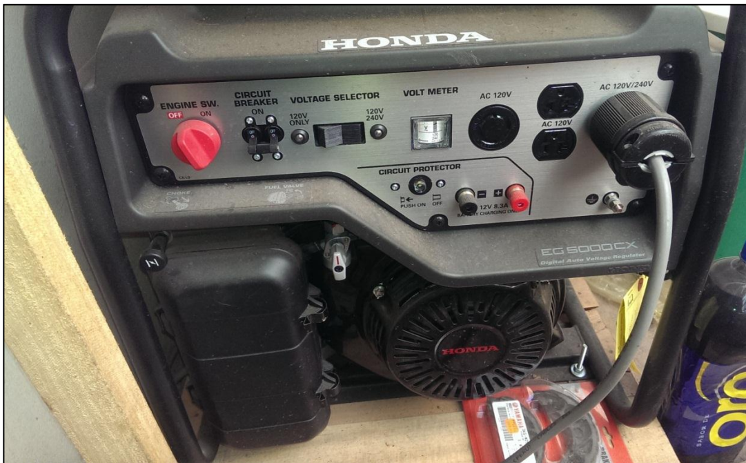
Figura 33: Generador eléctrico para respaldo de energía Fuente: Elaboración propia
