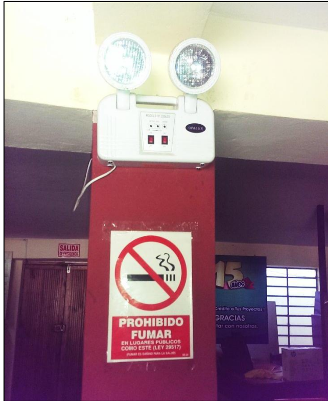
Figura 37: Señalización e instalación de luces de emergencia Fuente: Elaboración propia
