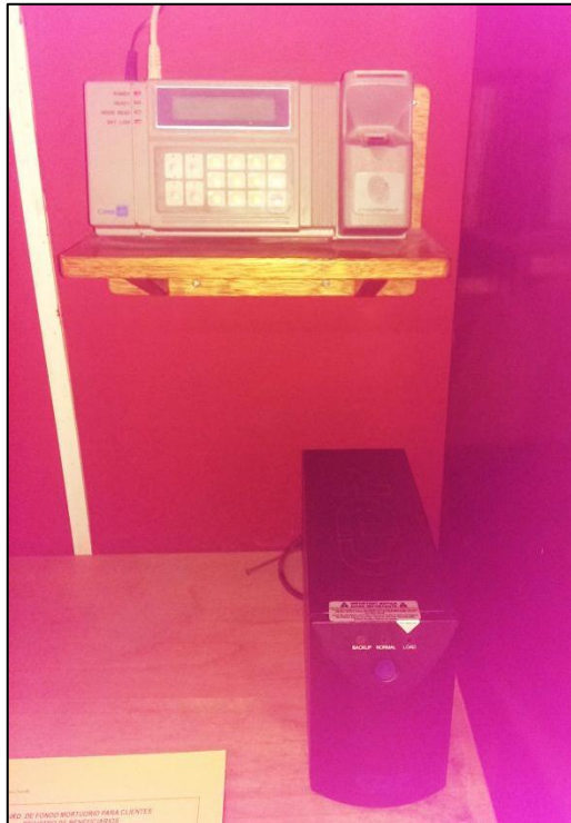
Figura 35: Dispositivos SAI (UPS) Fuente: Elaboración propia
