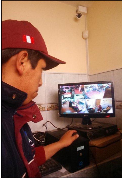
Figura 36: Instalación de sistemas de video vigilancia Fuente: Elaboración propia
