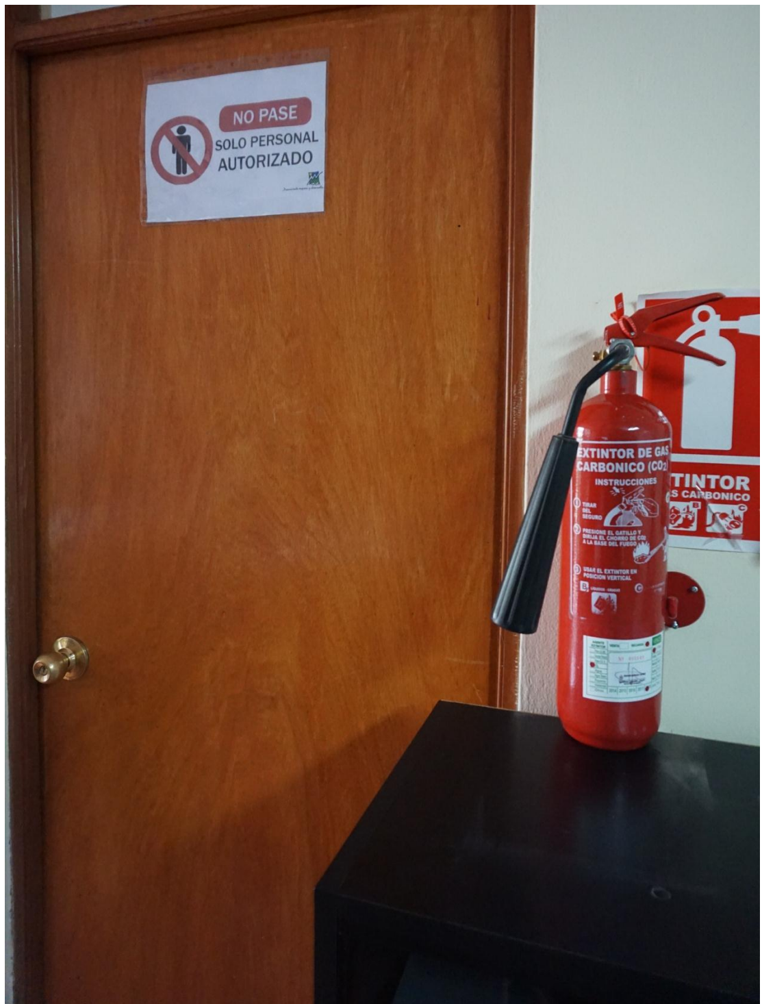
Figura 39: Señalización e instalación de extintores de gas carbónico Fuente: Elaboración propia
