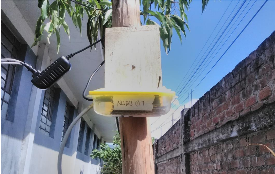
Figura 68: Nodo 01 instalado. Fuente: Elaboración propia.
