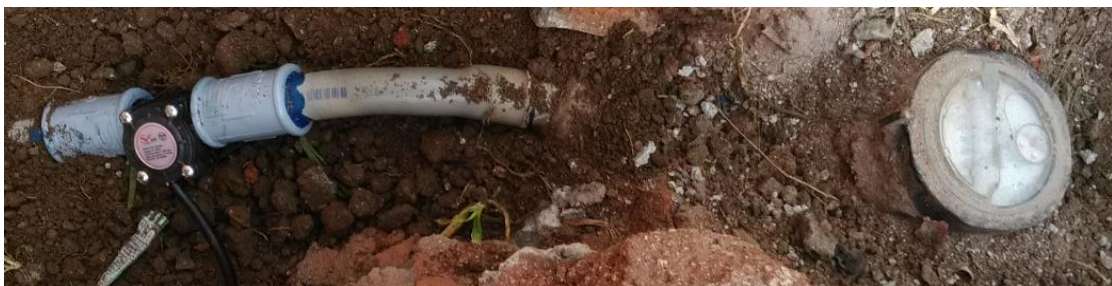
Figura 67: Instalación del sensor de flujo. Fuente: Elaboración propia.
