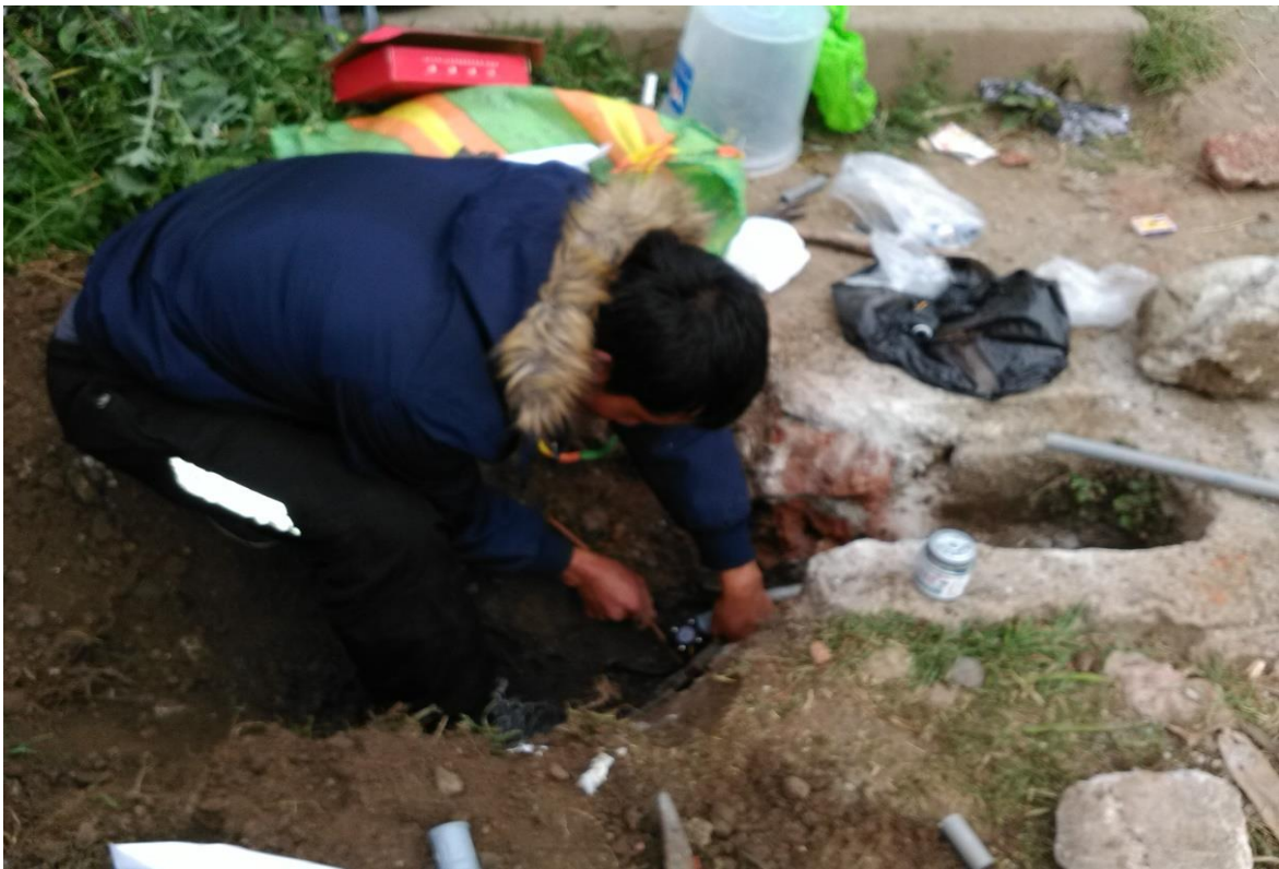
Foto1: Instalación del sensor de flujo al lado de la llave principal de agua.
