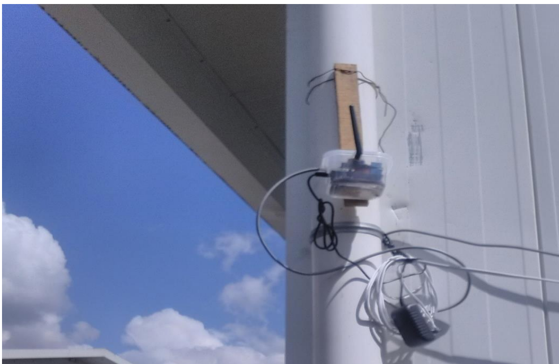
Figura 69: Nodo coordinador instalado. Fuente: Elaboración propia.
