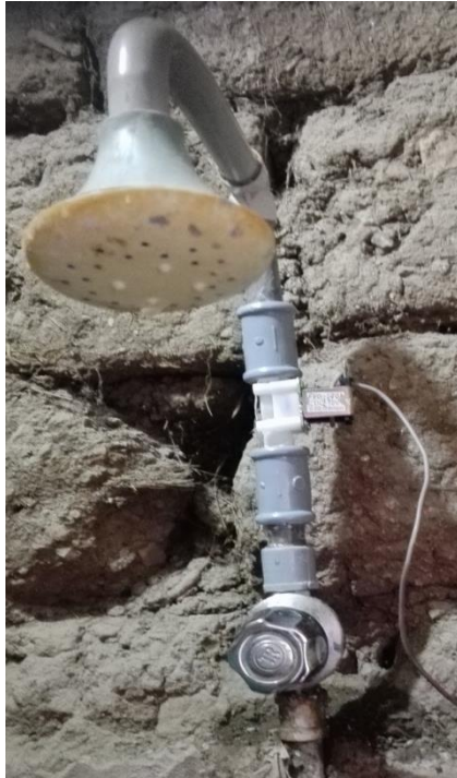
Figura 37: Verificación y validación válvula ducha. Fuente: Elaboración propia.
