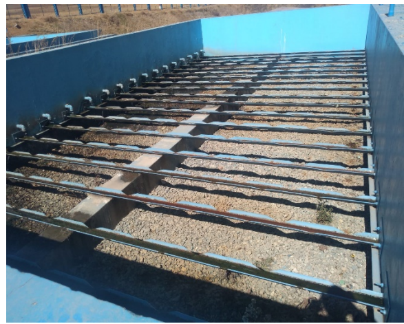
Fotografía 19: Filtro percolador de la PTAR
