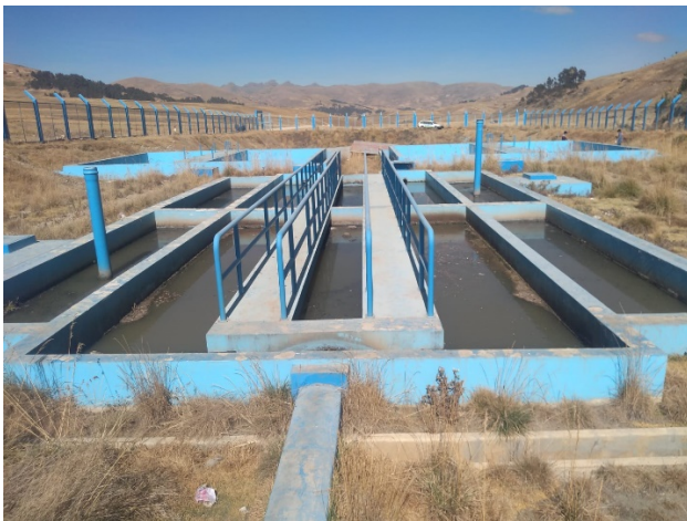
Fotografía 18: Tanque Imhoff de la PTAR
