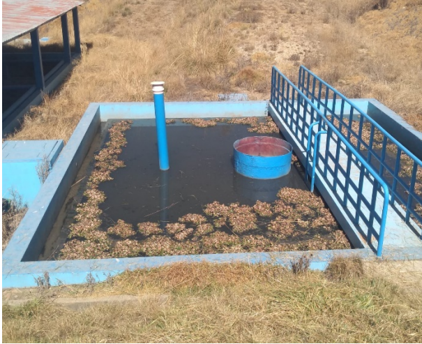
Fotografía 20: Sedimentador secundario de la PTAR
