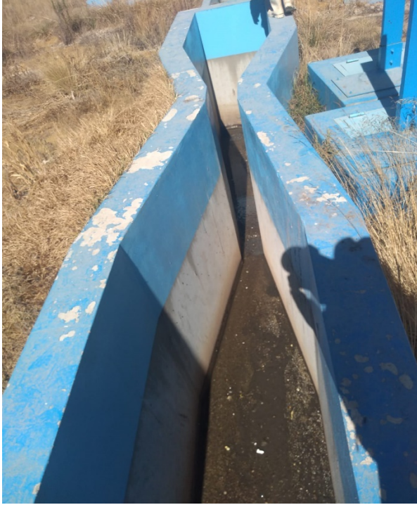
Fotografía 16: Canal Parshall de la PTAR
