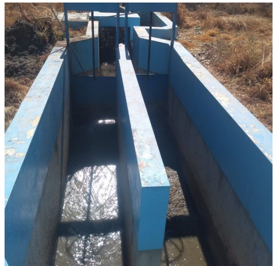
Fotografía 15: Desarenador de la PTAR
