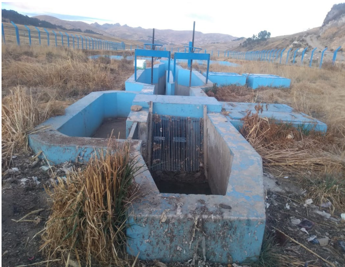
Fotografía 14: Cámara de rejas de la PTAR
