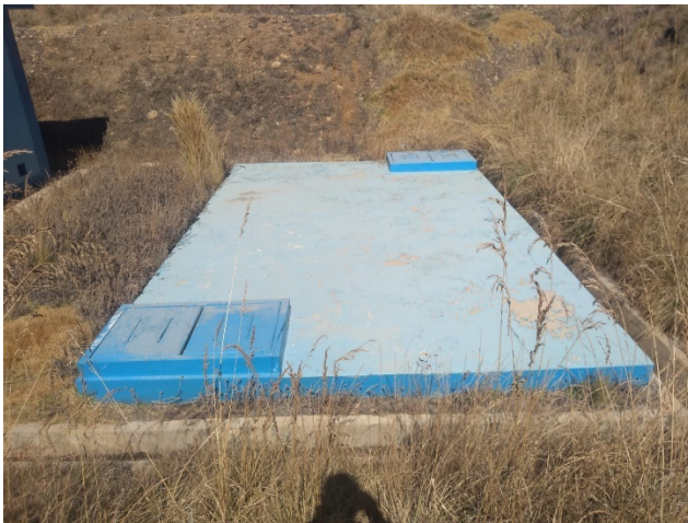
Fotografía 22: Cámara de cloración de la PTAR
