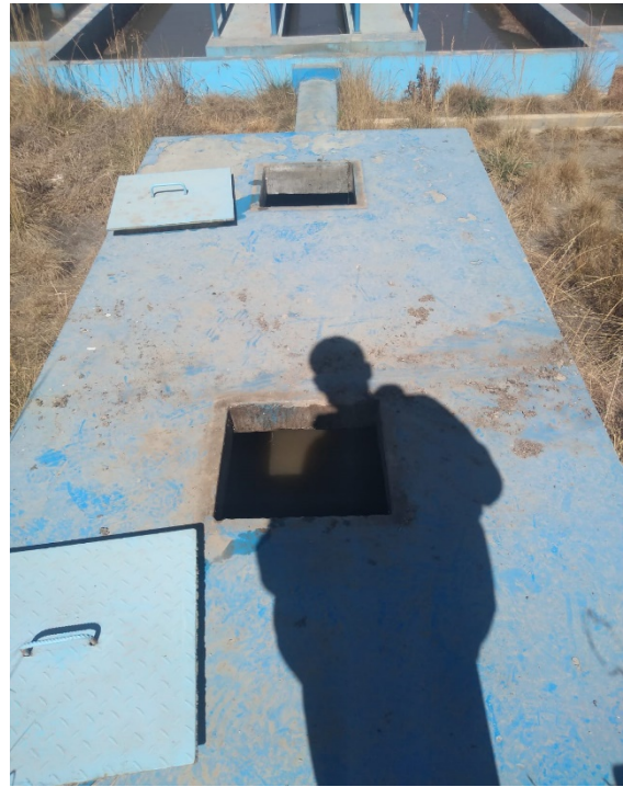
Fotografía 17: Cámara desgrasadora de la PTAR
